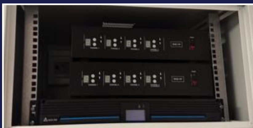
Szafa rack z zamontowanymi generatorami SNG HP
