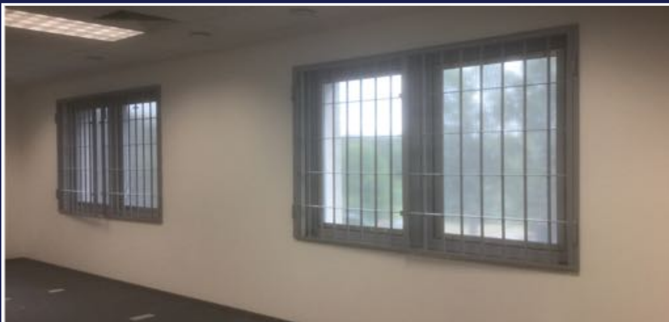
Pomieszczenie ekranowane elektromagnetycznie, na zdjęciu widok okien z przeziernym ekranem elektromagnetycznym.
