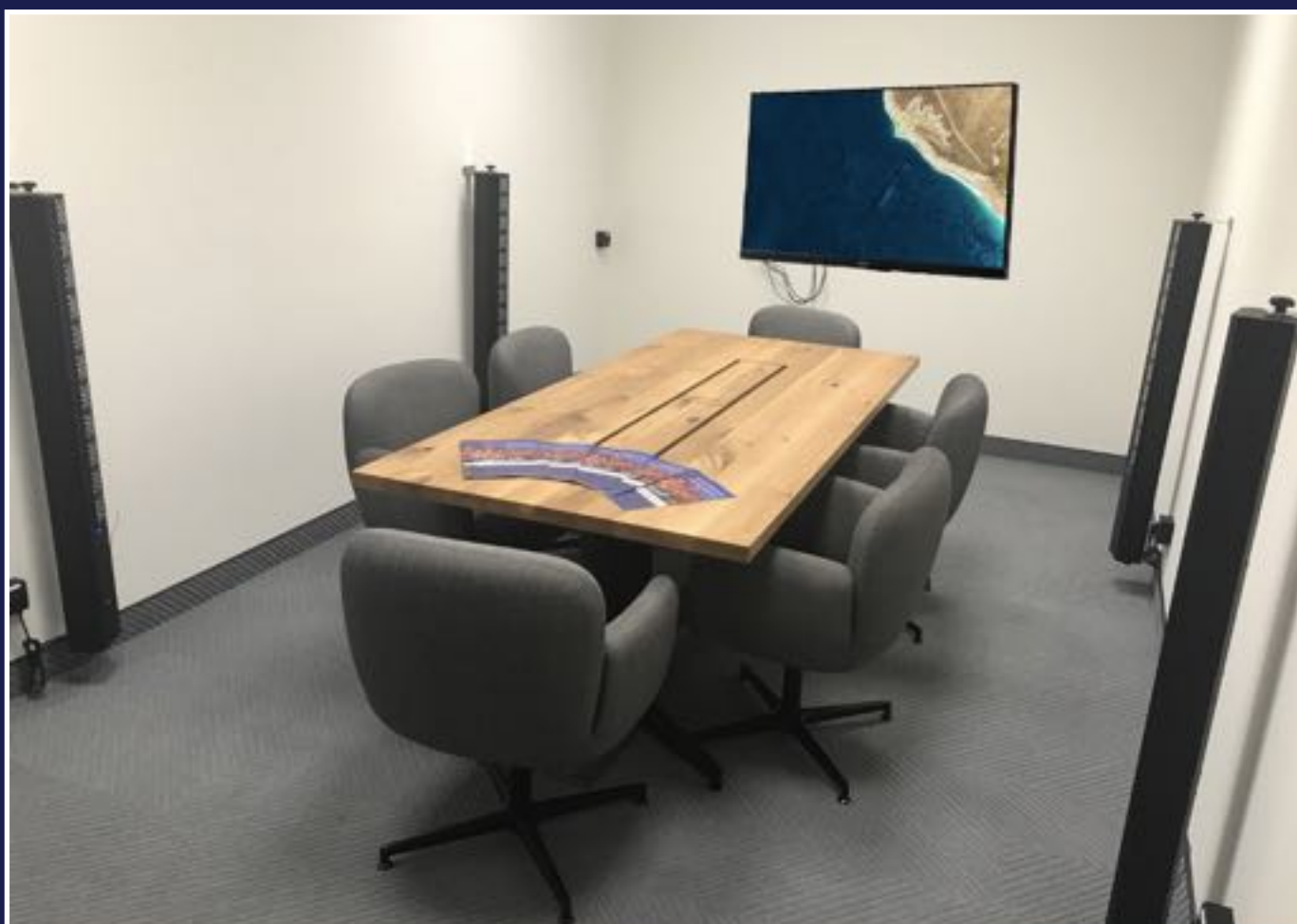
Sala konferencyjna, zabezpieczenie wibroakustyczne, akustyczne, elektromagnetyczne. Na zdjęciu widok 4 kolumn systemu Protektor Long - uniemożliwiającego dokonywanie nagrań audio.
