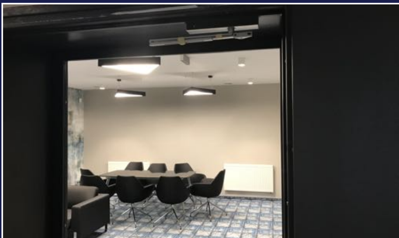
Sala konferencyjna, system wibroakustyczny, ekranowanie akustyczne i elektromagnetyczne, widok przez kasetę śluzy wejściowej.
